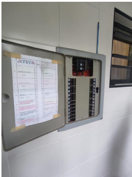
Foto 23 - QUADRO DE LUZ
